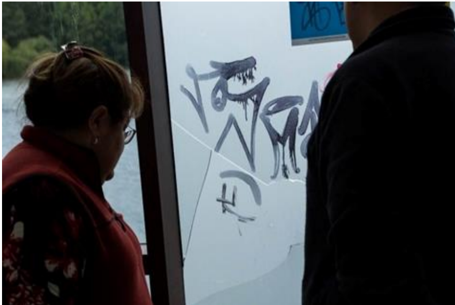
Imagen 03: daños en vidrios y ventanales.
